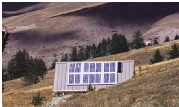
Une priorité si votre installation n'est pas reliée au réseau : veillez à bien maîtriser votre consommation électrique !
